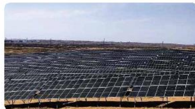
250MW | 宁夏宁东光伏复合发电项目 宁夏·中国 | 地面电站
