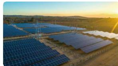
1.5MW | 巴西-Setta太阳能电站项目 伯南布哥州·巴西 | 地面电站
