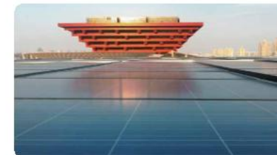
3.14MW | 世博会中国馆光伏建筑一体化项目 上海·中国 | BIPV项目
