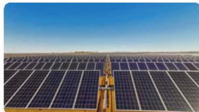
250MW | 南非-Kimberly Droogfontein 太阳能电站项目 南非 | 地面电站
