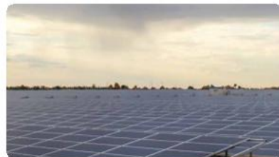
210MW | 地面电站 卡纳塔克邦图姆库尔区·印度
